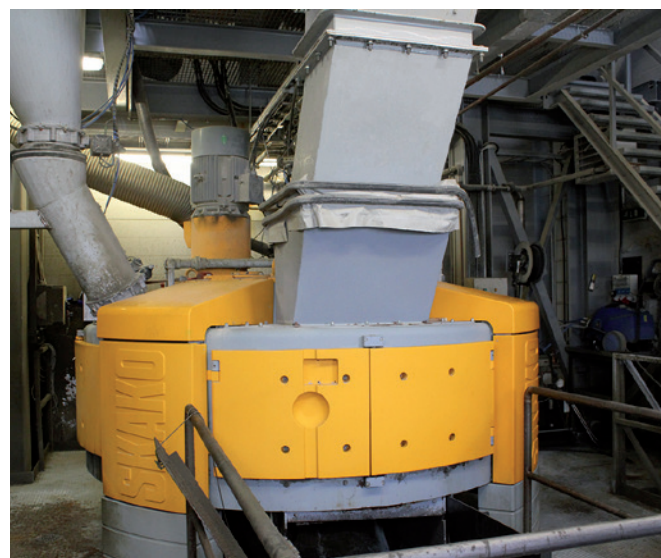
Silon i Hallsthammar förser bl.a fabrikens håldäckstillverkning med betong.
