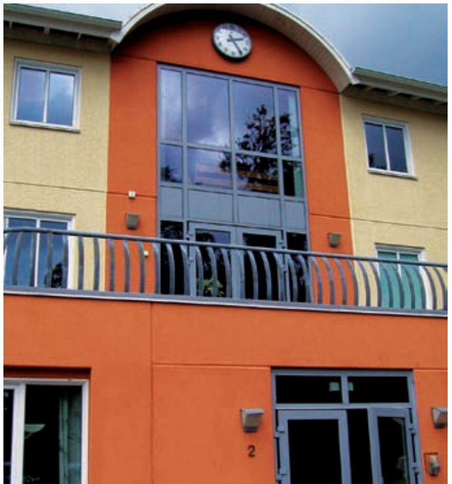
LK Fasadvägg har synliga fogar i fasaden.
